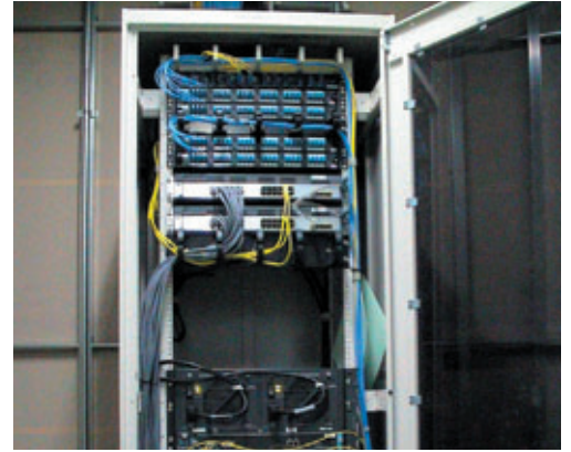
材料・物性総合研究棟内ネットワーク配線の中核部
